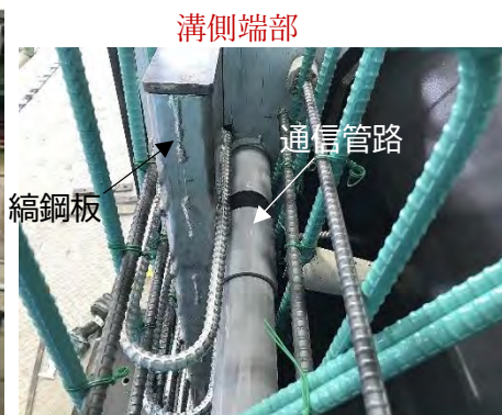
写真-4.5.2 バネ式通信管路端部配置例
