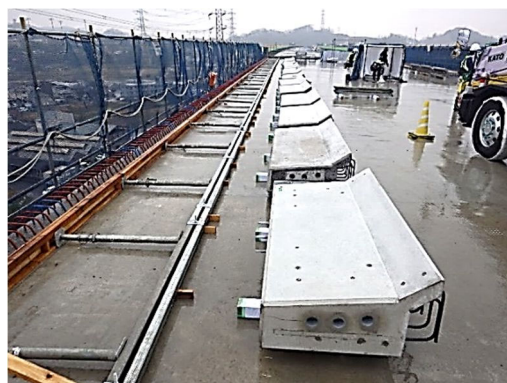
写真-7.2.2 橋面上に仮置きされた状況例
