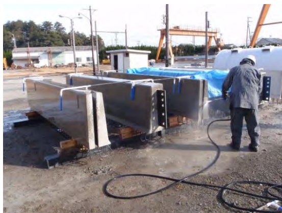
写真-4.8.2 小口面の洗出し状況例
